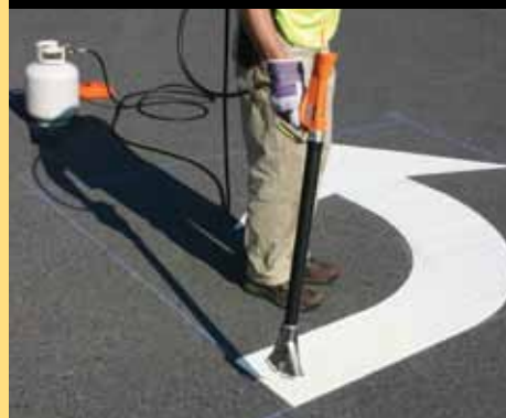
Chauffer le produit PreMark® à l'aide d'un chalumeau au propane comme le Flint 2000EXMC, puis utiliser un poinçon pour vérifier l'adhérence du produit.
